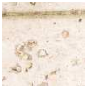
... en in detail de dooizoutschade
